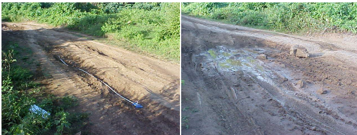
Figura 3.13 - Erosões na entrada da Cacimba e atrás da Usina de Tratamento de Lixo.
