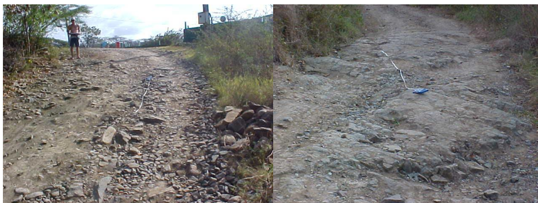
Figura 3.12 - Erosão nas estradas após Mirante do Boldró e na descida à praia.
