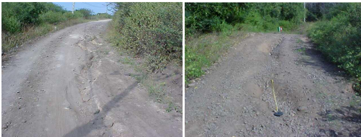
Figura 3.14 - Erosões no caminho da praia do Bode.
